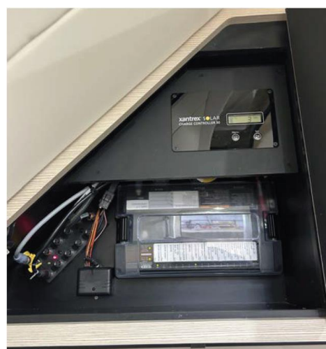
CZone & Solar Panel Monitor
