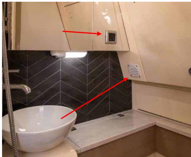
Exhaust Fan Intake
