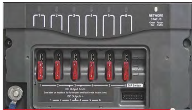
CZone Output Module Fuses
