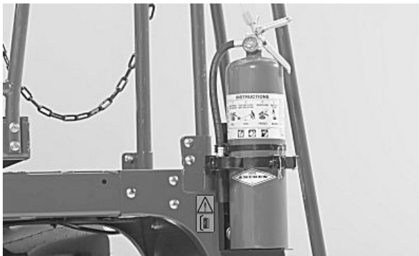
Eesmise tulekustuti asukoht
