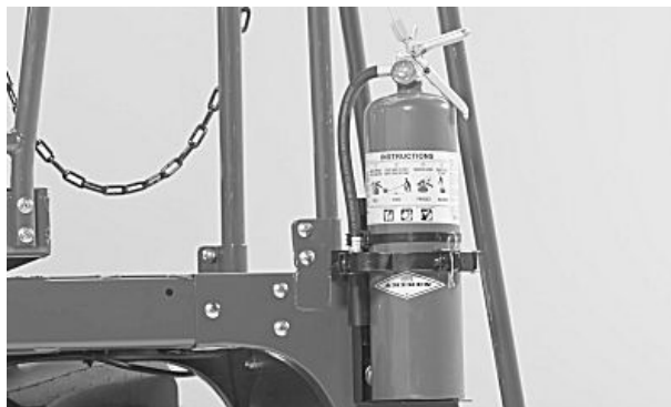
Prednja lokacija aparata za gašenje požara
