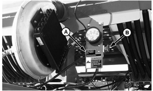
Interruptor del ventilador del CCS
