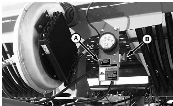
Interruptor del ventilador del CCS
