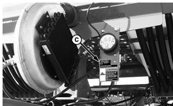
Interruptor del ventilador del CCS
