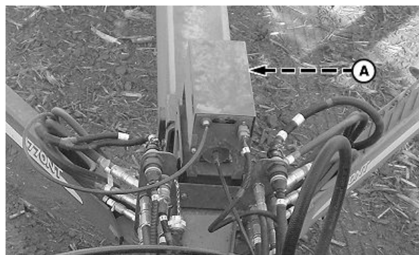
Реле на компресора
