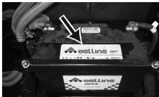
在蓄电池顶部
