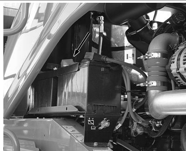
Аккумуляторные батареи на модели W110
