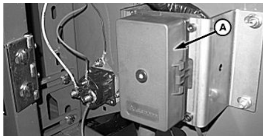
A—Tablero de fusibles (centro de alimentación)
