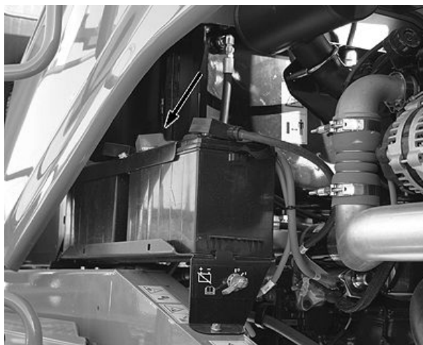
Аккумуляторные батареи на модели W110
