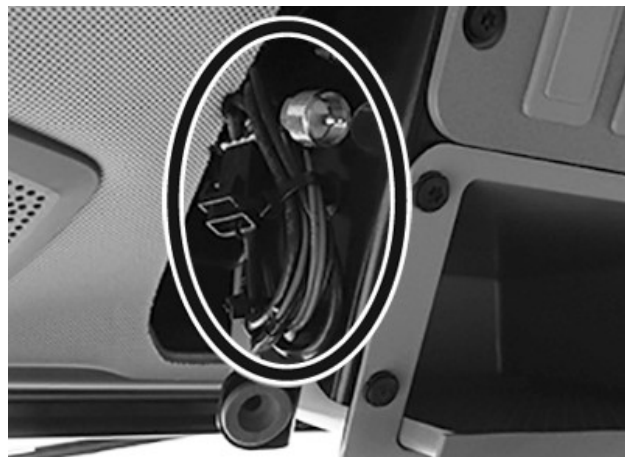
Antenne og strømkabler
