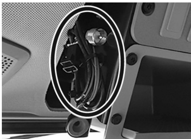
Przewody antenowe i zasilania
