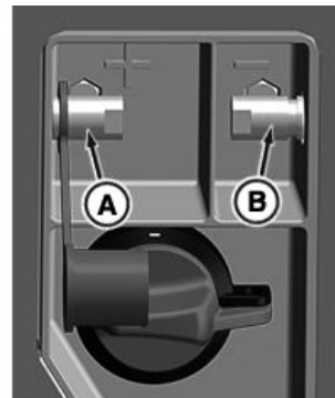
Regletele de borne pentru comutatorul de șuntare a bateriei sunt situate lângă scara tractorului.
