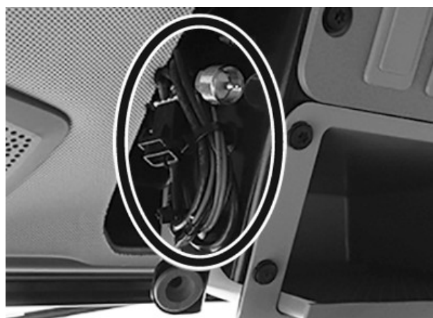
Antena y cables de alimentación
