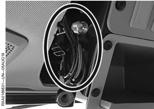
كابلات الكهرباء والهوائي
