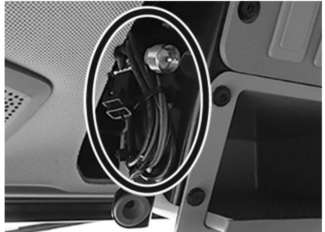
Antenn ja toitekaablid
