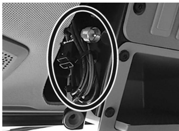
Antena ir maitinimo kabeliai
