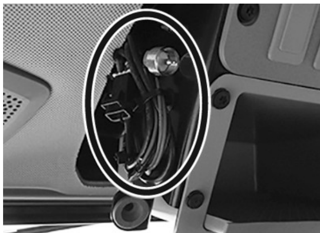
Przewody antenowe i zasilania RXA0169831—UN—05AUG19
