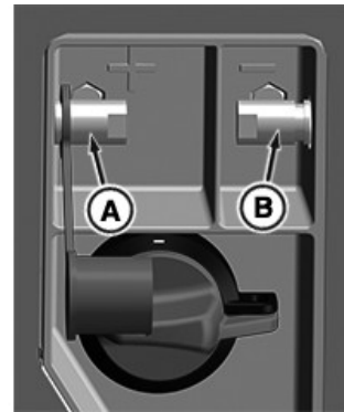
Die Pole des Batterie-Brückensteckers befinden sich in der Nähe der Traktorstufen. RXA0187645—UN—10AUG22
