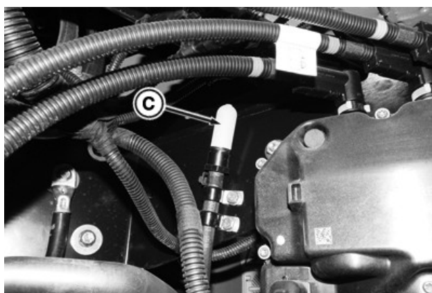
RXA0142031—UN—03JUN14 Вентиляційний фільтр бака для сечовини (DEF) (C) розташований у відсіку акумуляторної батареї над дозатором рідини для очищення дизельних вихлопних газів.
