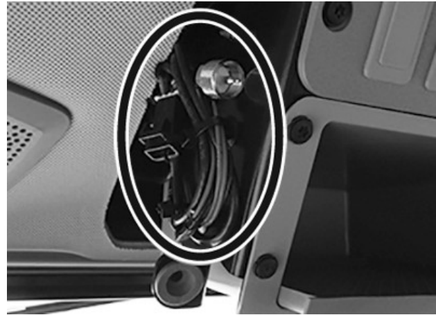
Antenn ja toitekaablid
