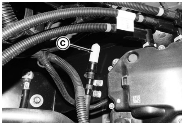
RXA0142031—UN—03JUN14 DEF-tankens udluftningskanalfilter (C) sidder i batterirummet over DEF-doseringsenheden.
