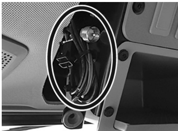
Antena y cables de alimentación
