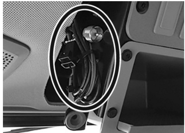
天线和电源电缆
