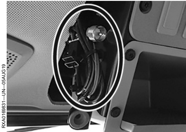
كابلات الكهرباء والهوائي
