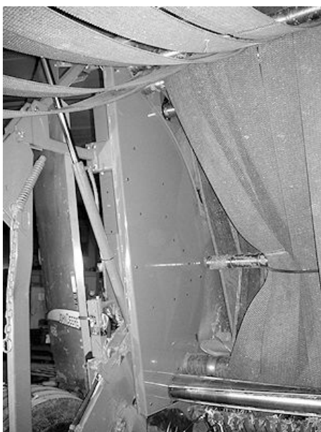
Painel de Desgaste da Estrutura Principal Mostrado
