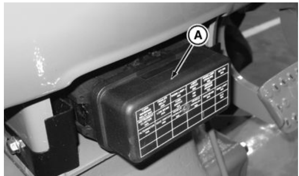
Plassering av sikringsboks, IOOS
