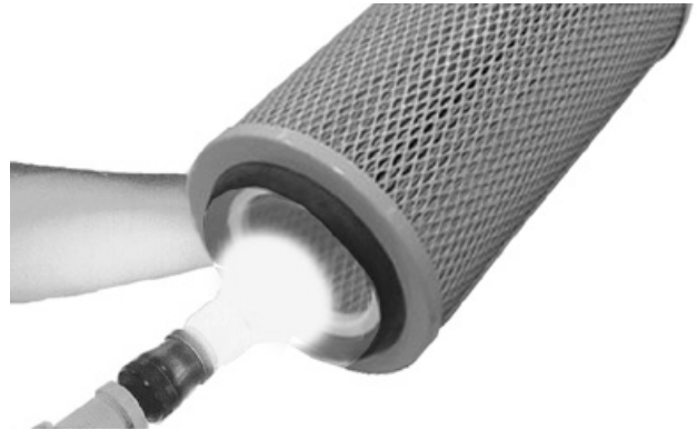
Inzetstuk filter inspecteren
