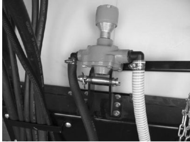
Remisage de la pompe
