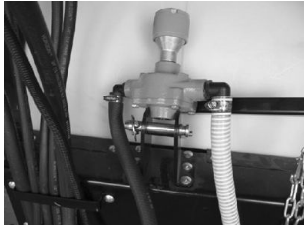
Almacenamiento de la bomba
