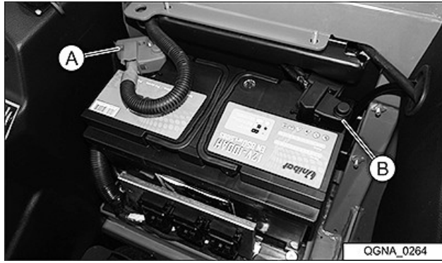
A—Cable positivo B—Cable negativo (masa)
